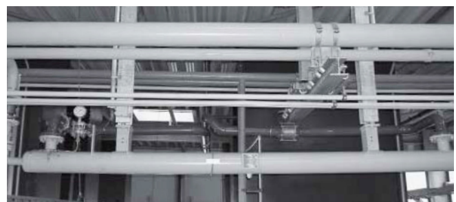
Bild 9. GuD-Kraftwerk mit DSWÜ (unten) zur Vorwärmung des Brenngases mit der (Ab)wärme des Schmieröls einer Gasturbine Solar Taurus 60 S (Foto: SW Düsseldorf).
