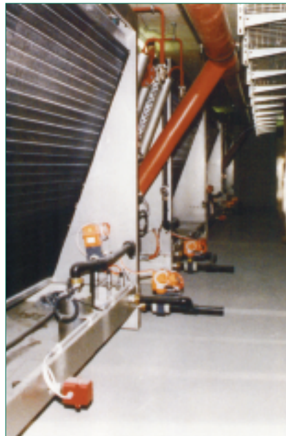
Bild 3: Im Gebäude eingebaute Hybridkühler
