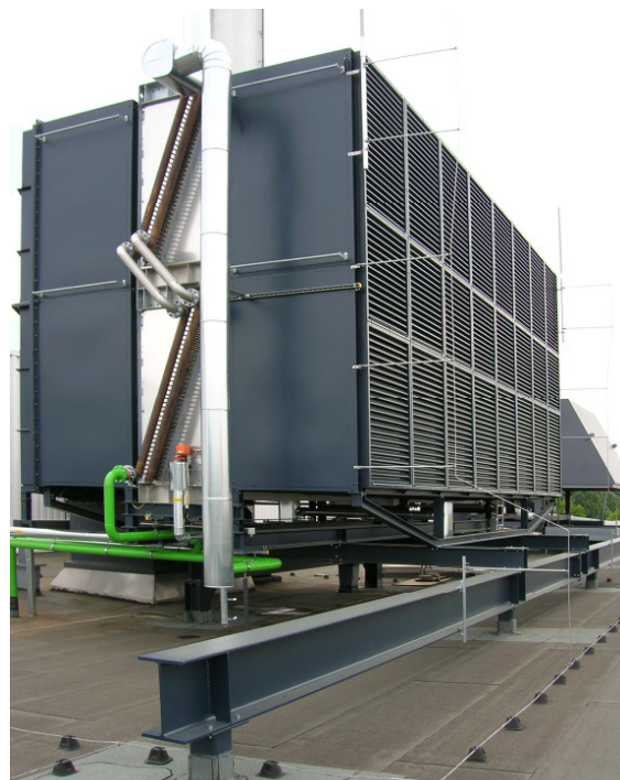
Filterhaus mit HVLK und dreistufiger Luftfilterung an GT 1
