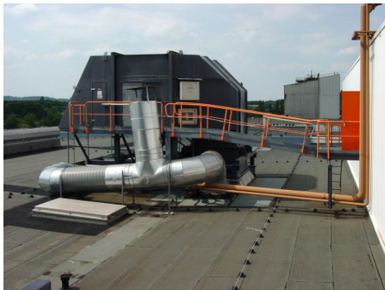
Ehemaliges Filterhaus der GT 1 mit Anti-Icing mit Abluft
