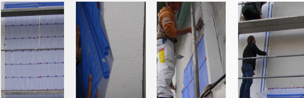
Bild 8: Herstellen eines Kapillarrohrmatten-Absorbers im Außenputz der Wärmedämmung [22] v.l.n.r.: Fixierung der Kapillarrohrmatten auf der Polystyrol-dämmschicht, Integration der Stammrohre, Spachteln des Absorbers, Anbindung der Versorgungsleitungen. (Quelle: A. Born / Sova)
