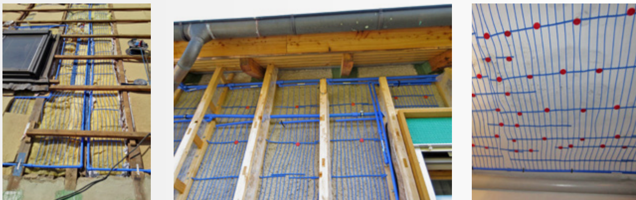
Bild 9: Umsetzung einer Kapillarrohrmatten-Umfangsheizung bei der energetischen Ertüchtigung eines Einfamilienhauses. v.l.n.r.: im Dach, an der Außenwand, an der Kellerdecke – jeweils vor Anbringung der Wärmedämmung [1]. (Quelle: A. Lucke / Thermo Integral)
